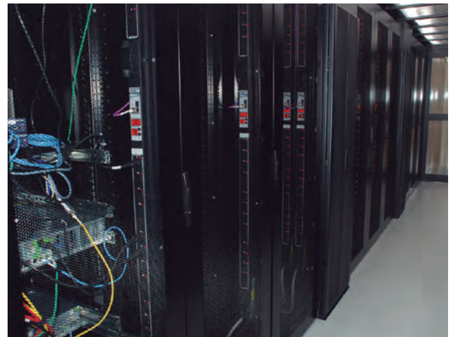
ラックに取り付けられた「Dominion PX」シリーズ。写真は0Uサイズ、20アウトレットのもの。コンセント単位で電流量や電圧値などを計測し、リモートから電源供給のオンオフも制御が可能。
