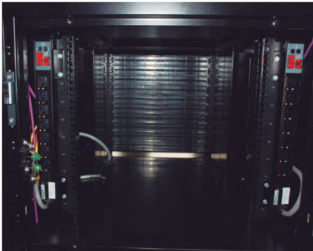
1Uタイプの「Dominion PX」シリーズを縦にしてラック内の側面に設置。スペースの有効活用と使い勝手を向上させている。
