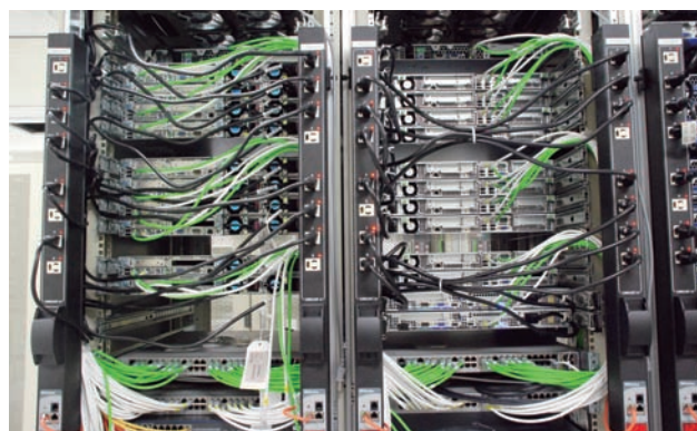
中央電子製ラックに設置。ケーブルをコーポレートカラーである白・黄緑で統一。ごちゃつきがちなラック背面をすっきり見せている。
