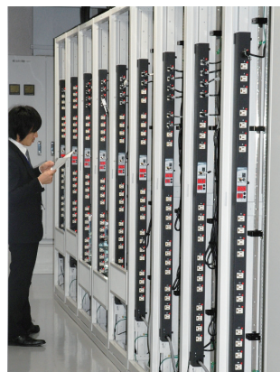
各ラックに設置されたDominion PX
